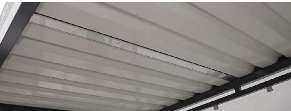
LED-Leuchte im Dach integriert
