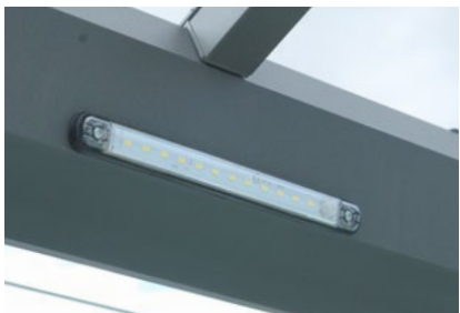
Solar LED Beleuchtung im Dach
